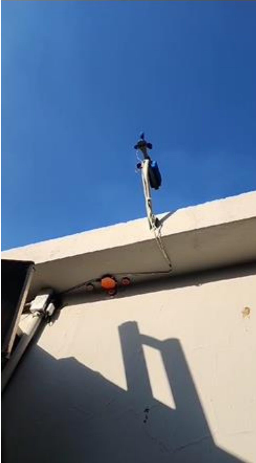
Figura – Instalação de pluviômetro na Escola
