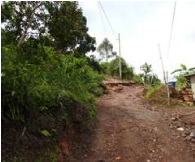
D Degráus de abatimento e postes inclinados – Ouro Preto/MG, 2022.
