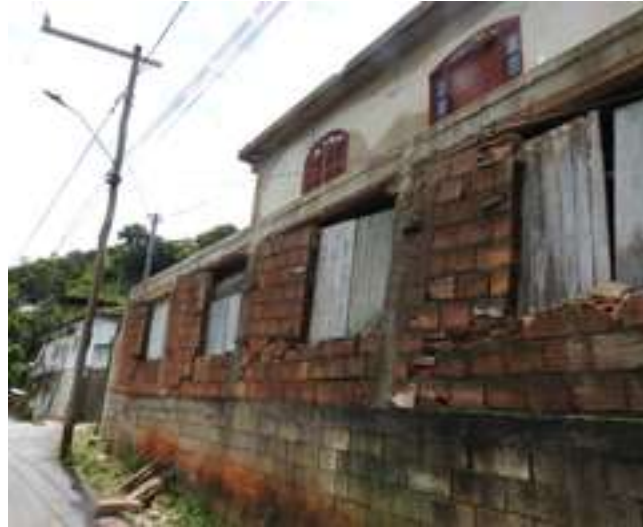
E Colapso de estruturas – Ouro Preto/MG, 2022.
