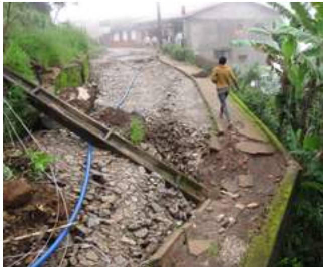
H Colapso de estruturas e trincas no terreno – Ouro Preto/MG, 2022.
