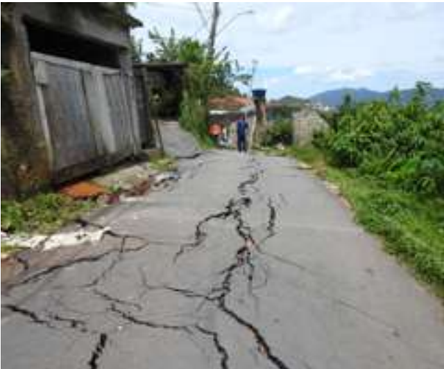
C Trincas no pavimento – Ouro Preto/MG, 2022.
