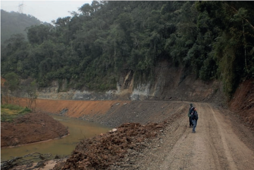
Inspeção de grande área reabilitada: Zona rural de cidade do Alto Vale do rio Itajaí-Açu/SC.
