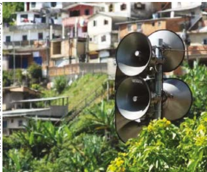
Sirenes de alerta contra desastres em favelas do Rio
