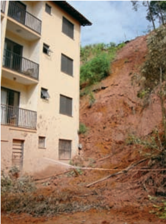
Escorregamento atinge base de edifício, construído próximo a talude de corte de alta declividade em Taboão da Serra (Janeiro de 2011). Foto: Acervo IG.
