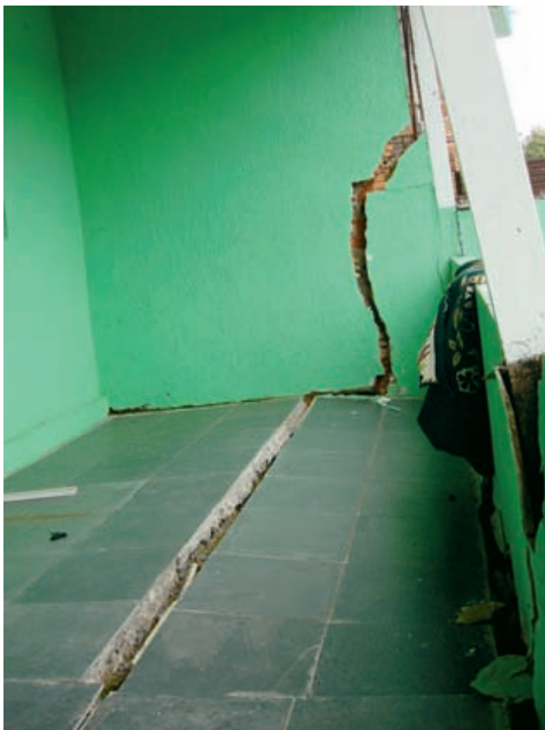
Trinca em área externa de moradia em Guaratinguetá (Janeiro de 2010). Foto: Acervo IG.
