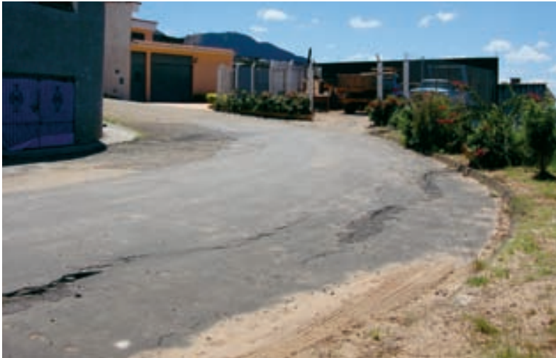
Trincas no asfalto – Águas de Lindóia (Março de 2010). Foto: Acervo IG.
