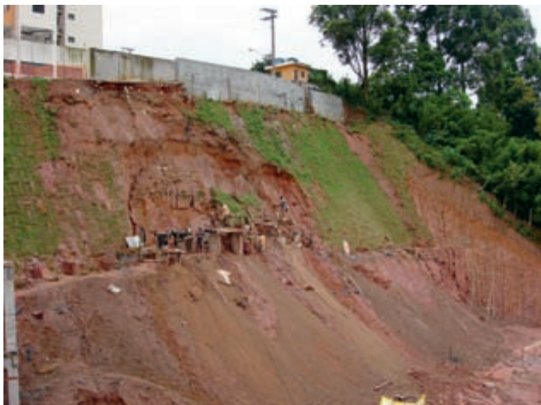
Intervenção antrópica em encosta no Taboão da Serra acentuando a declividade e causando escorregamento (Setembro de 2009). Foto: Acervo IG.
