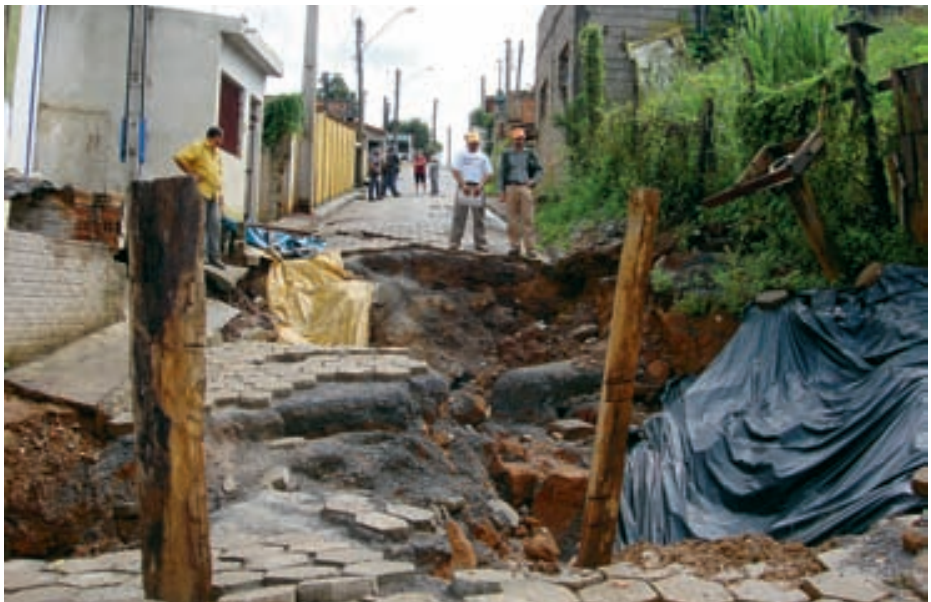
Subsidência em rua do Município de Guapiara (Fevereiro de 2010). Foto: Acervo IG.
