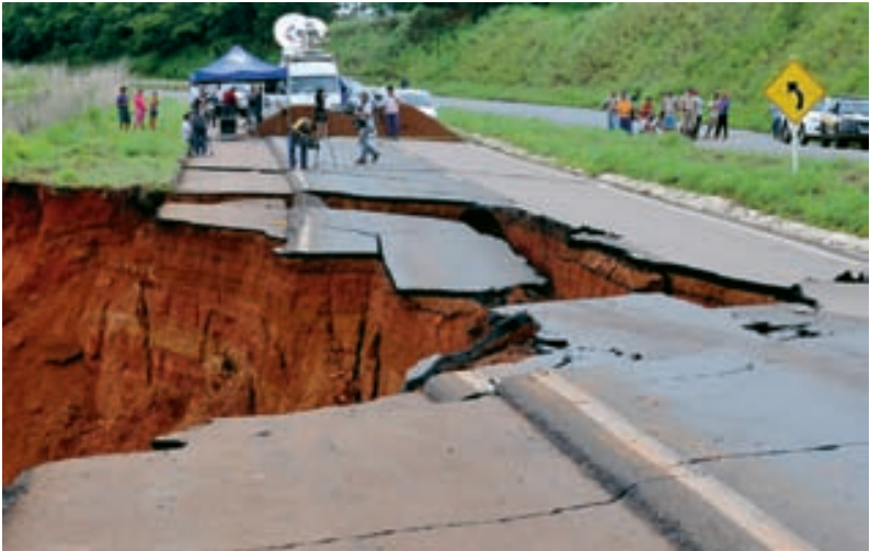
Escorregamento rotacional no km 24 da BR-060 (dezembro 2010). Foto: Valter Campanato - Agencia Brasil.
